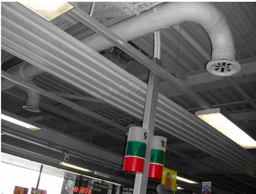
Figure 75: Plafond chauffant refroidissant dans une moyenne surface de vente (alimentaire)
